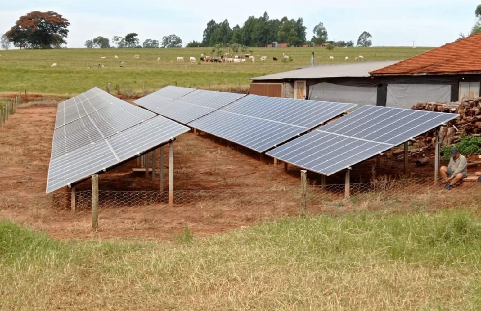
Instalação de energia solar do Instituto de Água e Terra (IAT) em Tapira, Paraná Crédito: IAT
